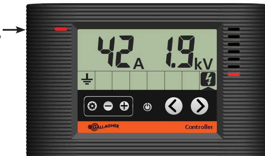
Controlador mostrando el Energizador en alarma de voltaje de salida
