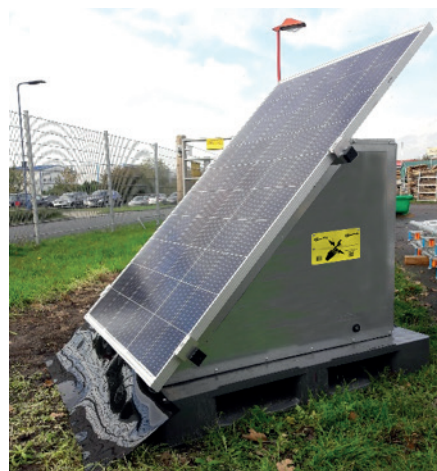
Figur 3.1: PVC-strippen sørger for, at der ikke falder skygge på solcellen på grund af plantevækst.
